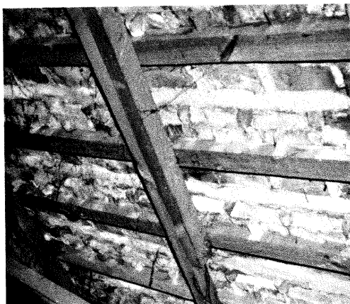
Bild 7: „Ersatz“ eines Sparrens durch eine Dachlatte
